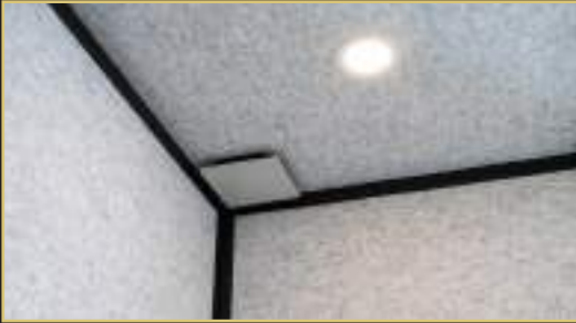
Ventilation et éclairage
